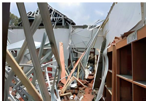
Gambar 4. Rusaknya bangunan gedung perpustakaan SDN Pandansari III akibat material vulkanik. Sumber: Tempo Data Science.
